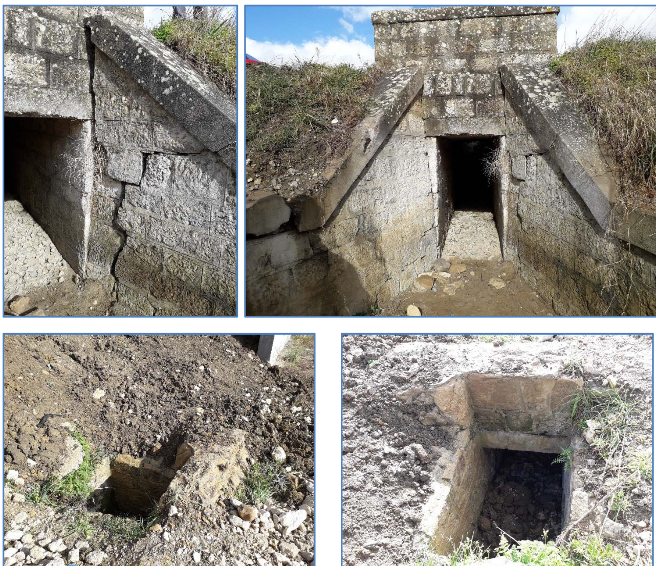
Figura 3 – Immagini fotografiche sulla stato fessurativo riscontrato sui manufatti di monte e di valle del tombino idraulico TS29D.
