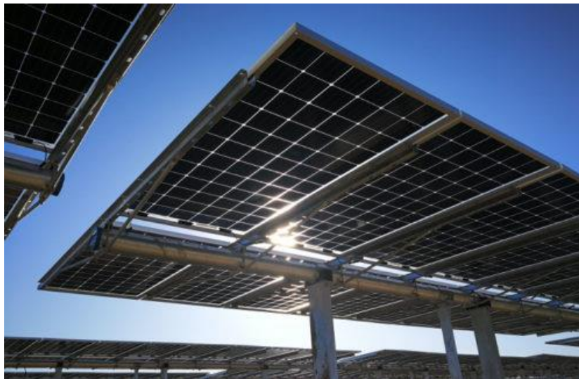
Figura 3.2: Esempio di struttura a tracker monoassiale.
