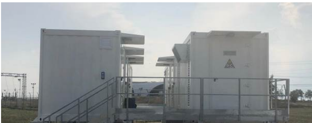
Figura 57: Esempio di installazione sistema BESS in impianto
