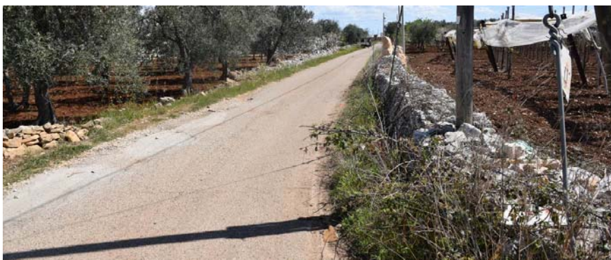
Figura 14: tratto di cavidotto esterno su strada vicinale Cardo.
