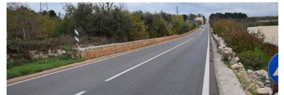
Figura 11: tratto della SS172 interessata dalla posa del cavidotto; il tratto in questione sarà posato con TOC.
