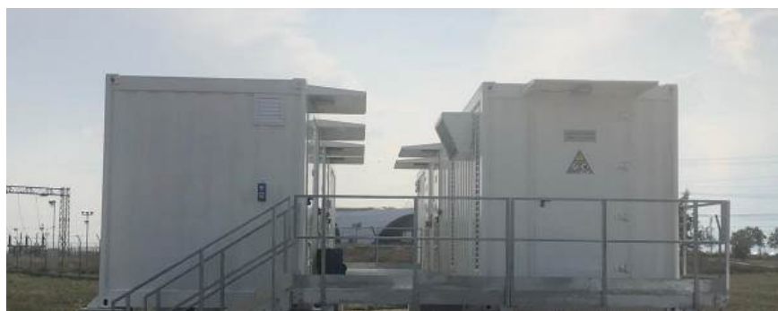
Figura 21: Esempio di installazione sistema BESS in impianto
