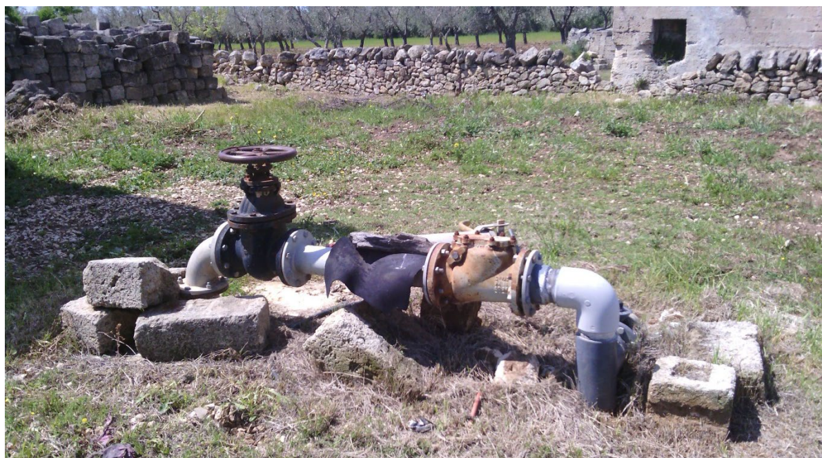
Figura 5: Tratto di condotta sotterranea
