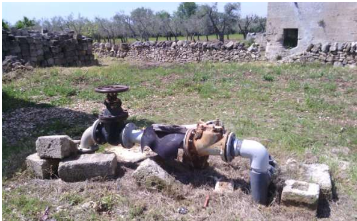
Figura 7: Porzione di condotta interrata visibile fuori terra.
