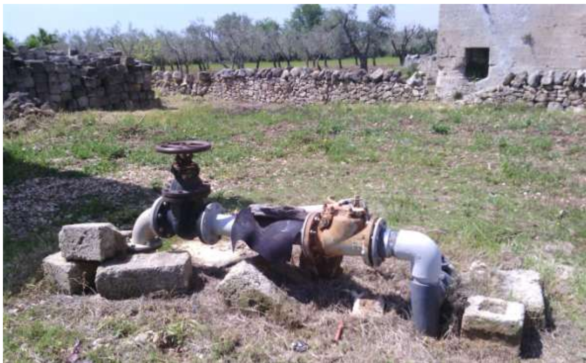
Figura 7: Porzione di condotta interrata visibile fuori terra.
