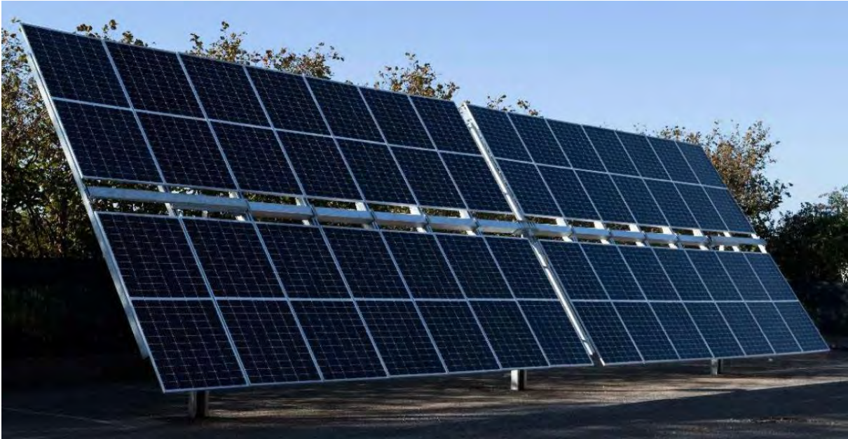
Figura 5-19 – Immagine esplicativa dell'allestimento dei pannelli sulla struttura tracker
