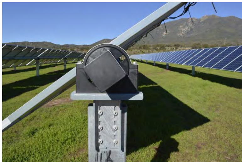
Figura 7-25 – dettaglio del tracker ad inseguimento
