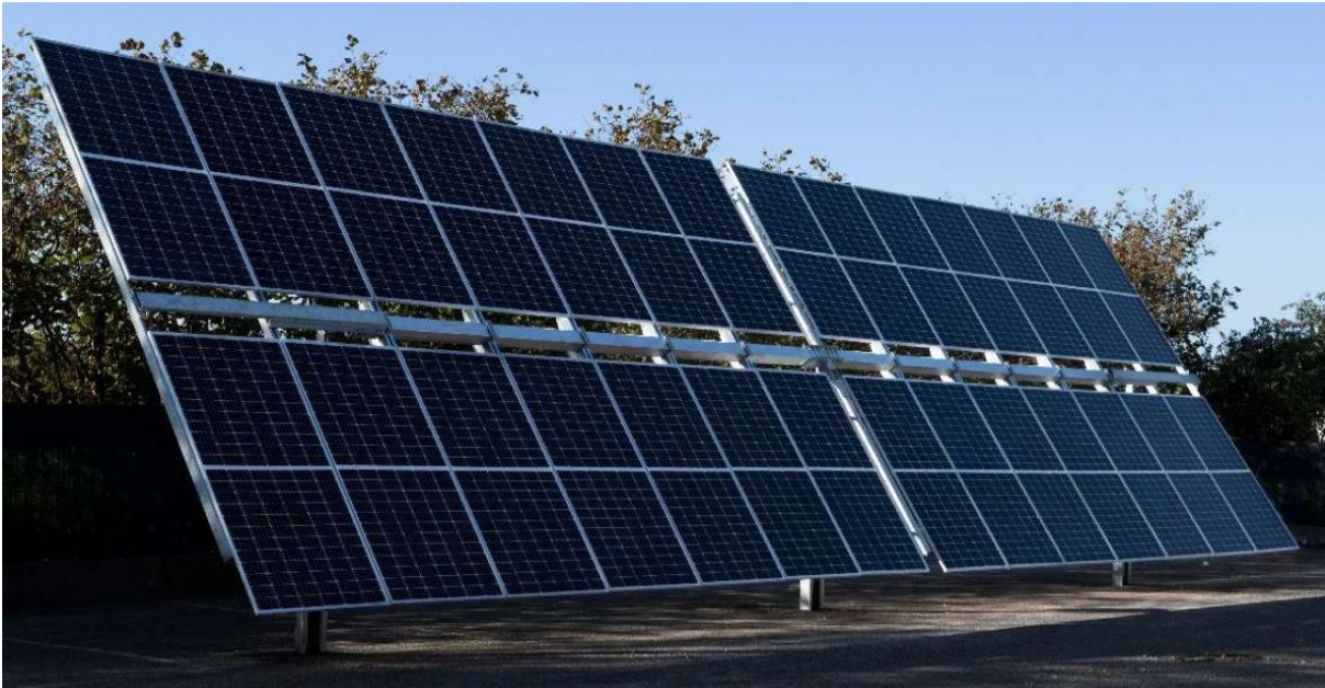
Figura 7-13 – Immagine esplicativa dell’allestimento dei pannelli sulla struttura tracker
