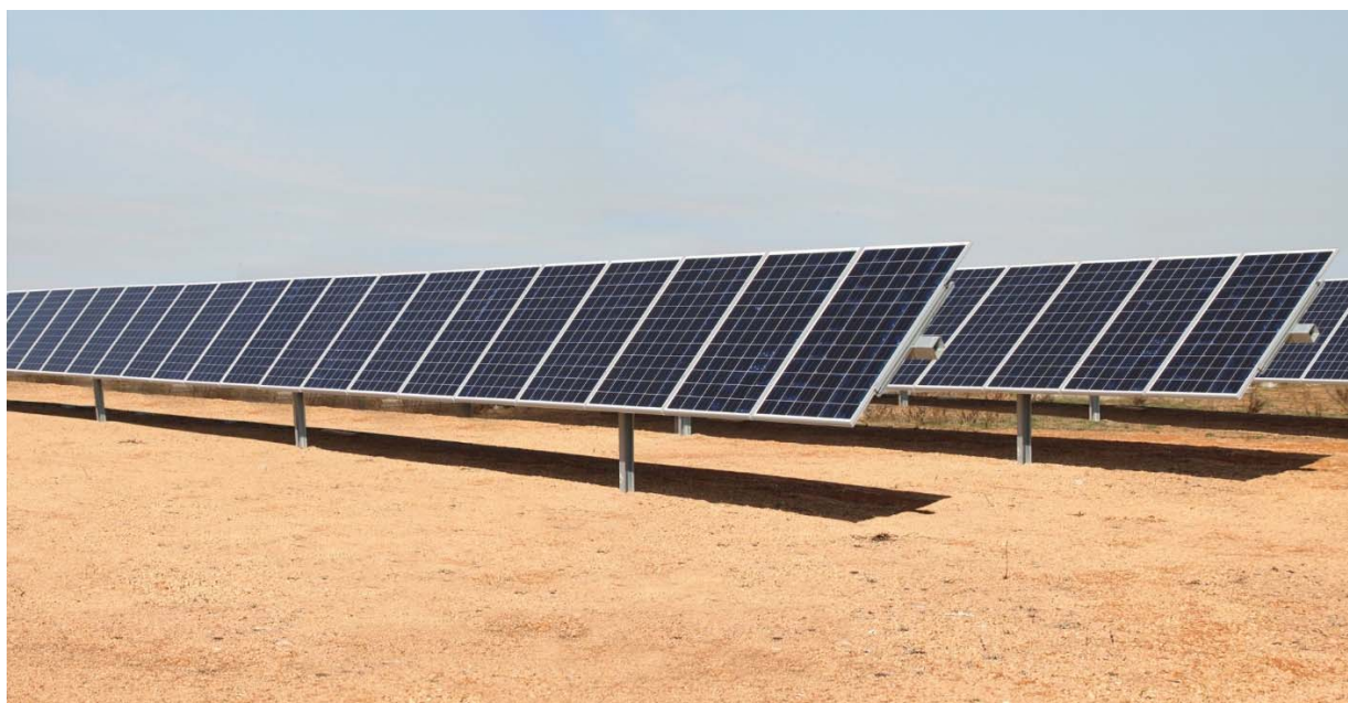
Moduli fotovoltaici su tracker monoassiali
