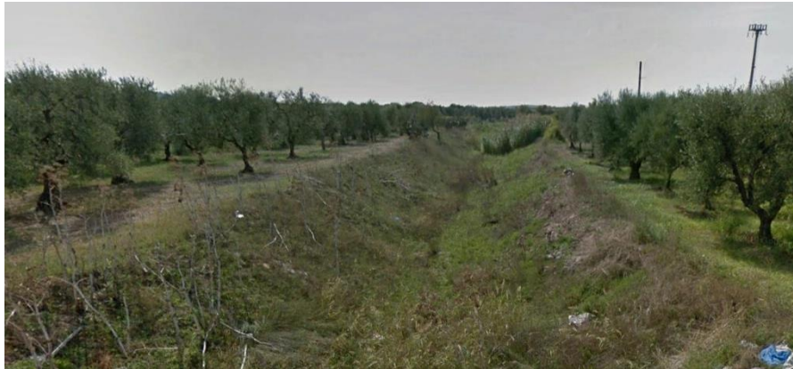
Figura 3.10: Sezione del Canale Castello in corrispondenza dell'attraversamento con il Tratturello Regio Ponte di Bovino.
