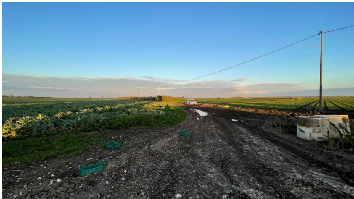
Figura 2.2: Linee Elettriche di Bassa Tensione in Sito
