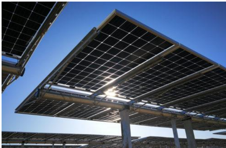
Figura 2.9 Esempio di struttura a tracker monoassiale
