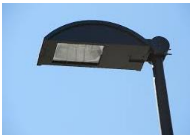
Figura 4.34: Esempio di apparecchio completamente schermato (full-cut-off).
