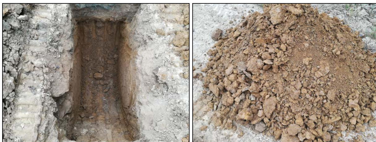
Foto 4: fase di realizzazione del pozzetto geognostico P2 (a sinistra) e materiale estratto (a destra).
