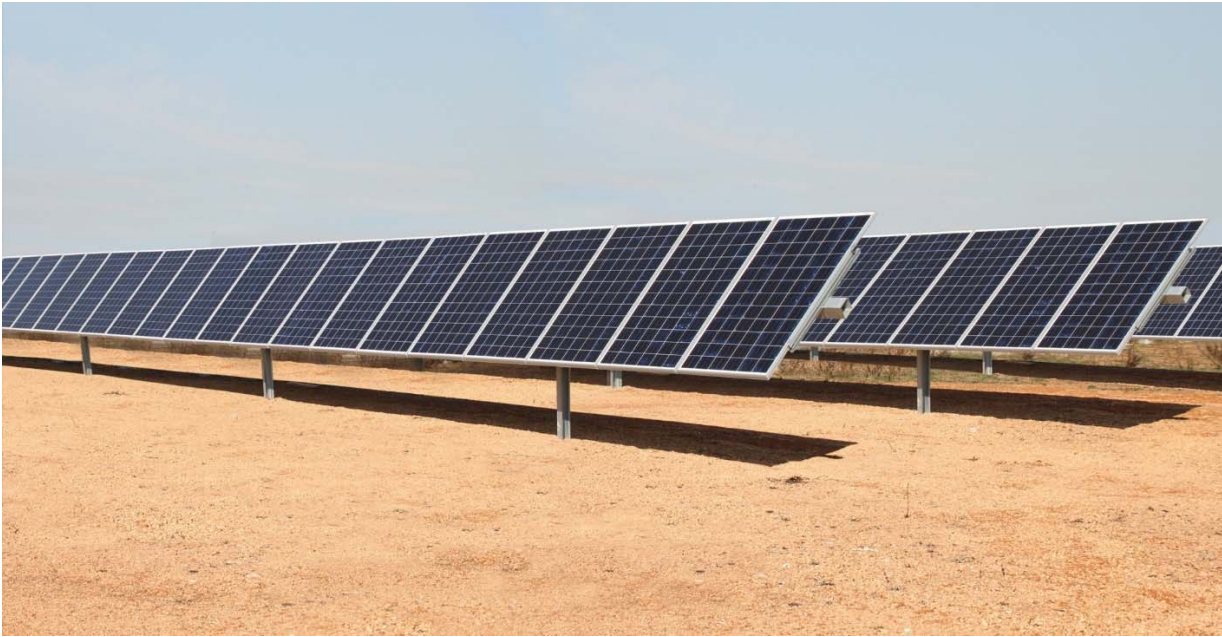
Moduli fotovoltaici su tracker monoassiali
