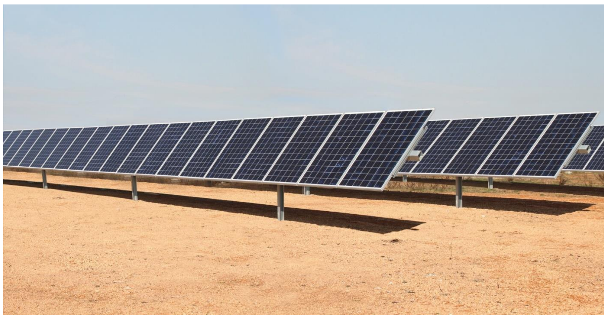
Moduli fotovoltaici su tracker monoassiali
