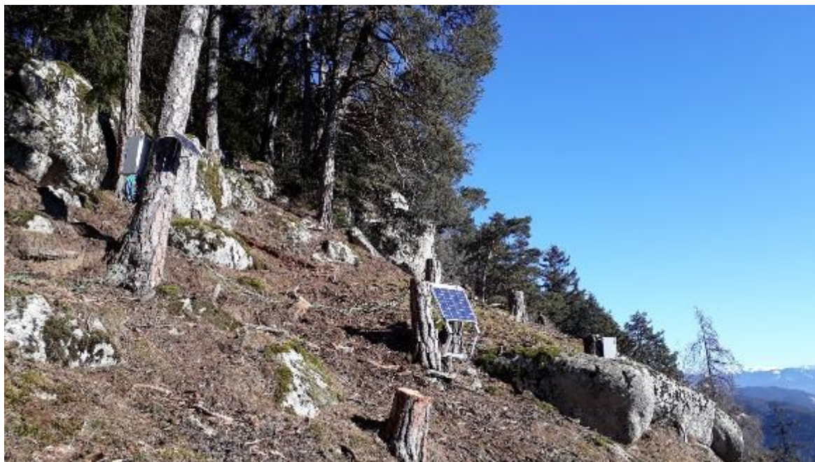
Fig. 6. Acquisitore geotecnico e stazione master d'allertamento installati sulla sommità della parete rocciosa oggetto del presente monitoraggio.
