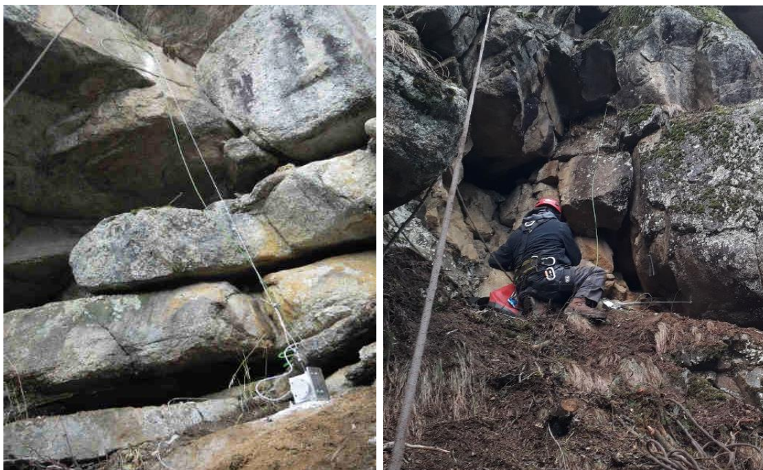
Figura 1. Esempi di installazione di estensimetri a filo (sx) ed a barra (dx) in funzione durante la realizzazione degli interventi di difesa in somma urgenza lungo la linea ferroviaria della val Pusteria (km 11+500 ca.).
