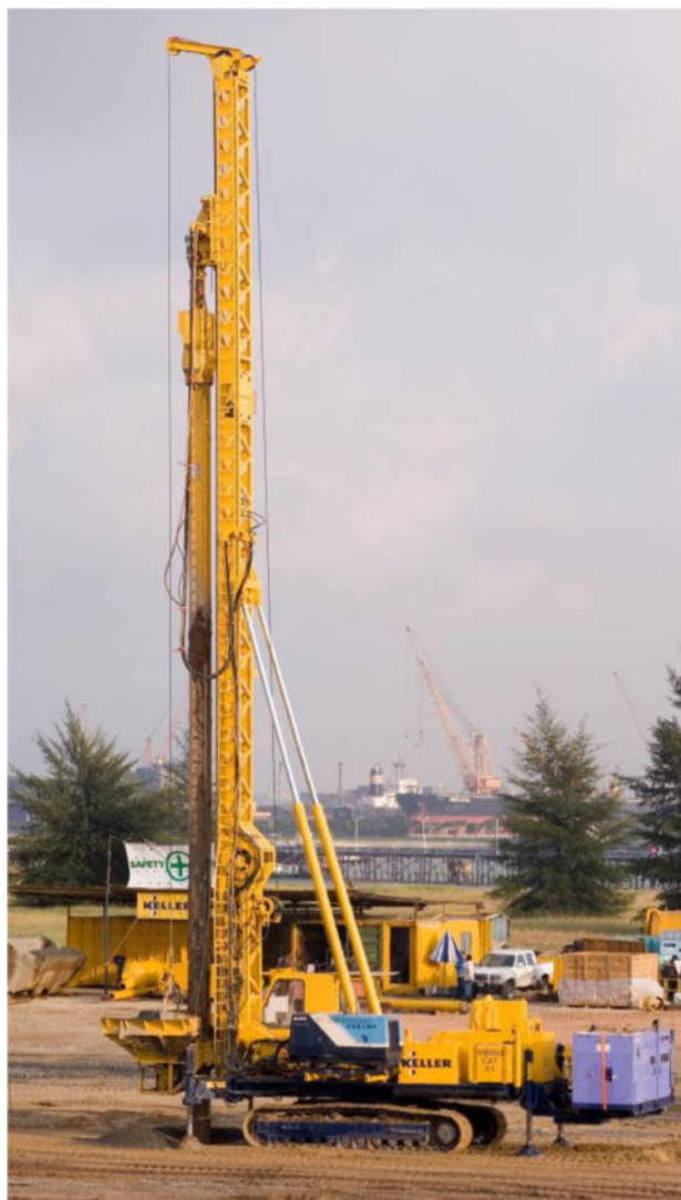
F 2. Tipica attrezzatura per colonne di ghiaia con immissione della ghiaia a secco a fondo foro
