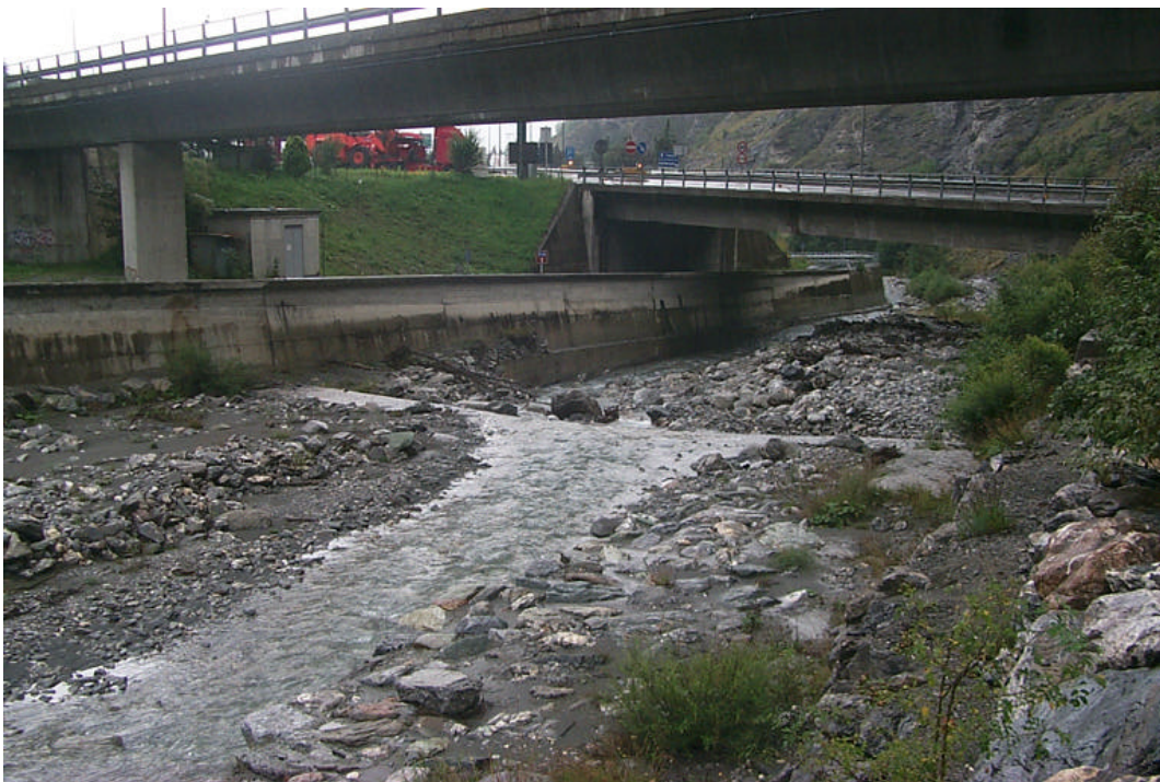
Photo 5.14 - Activité de l'érosion aux abords de la tête du Tunnel routier du Fréjus.
