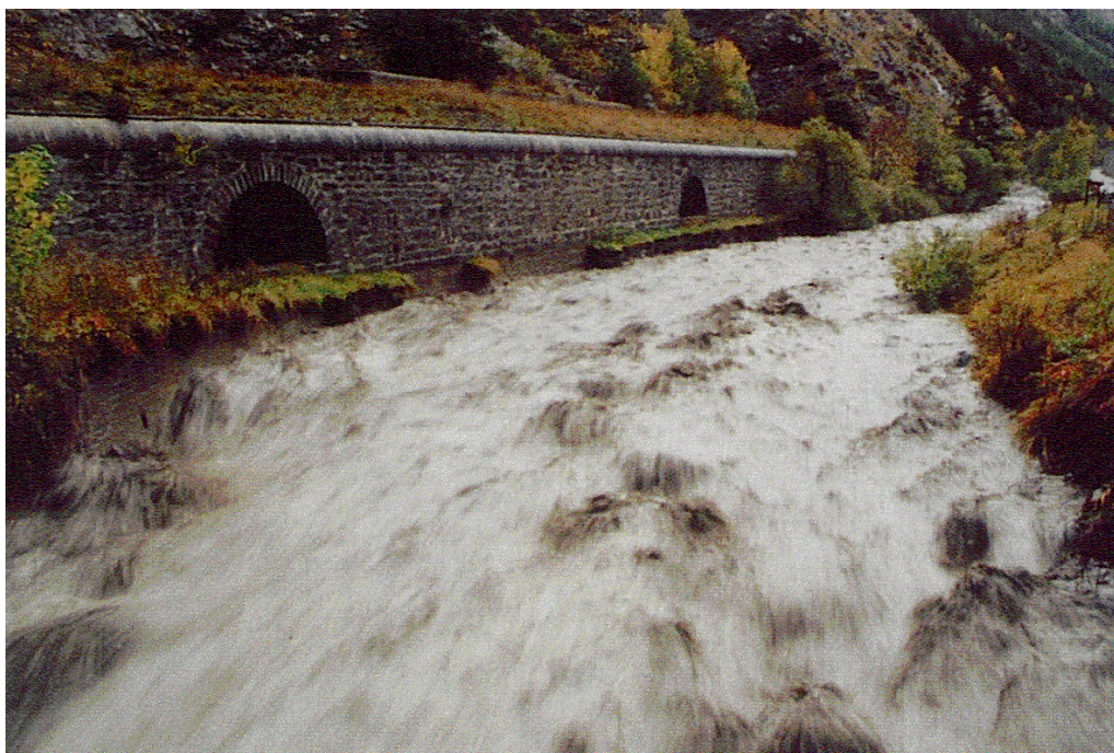
Photo 5.16 – Lit du T. Rochemolles près du Tunnel ferroviaire du Fréjus: le matin du 15 octobre 2000, le Torrent Rochemolles atteint de près les bouches d'aération (photo Nimbus 2001).
