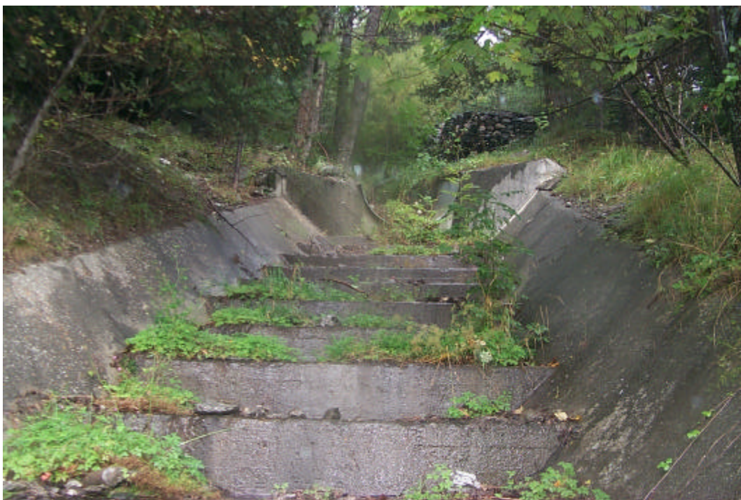
Photo 5.7 – Endiguement du ruisseau éphémère situé en amont de la tête du Tunnel routier du Fréjus: A) Gabions de protection du flanc gauche au droit d'un brusque détour du ruisseau.
