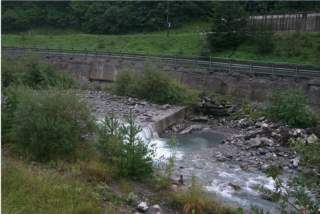
Photo 5.13 - Intense érosion avec approfondissement du lit en aval d'un seuil.
