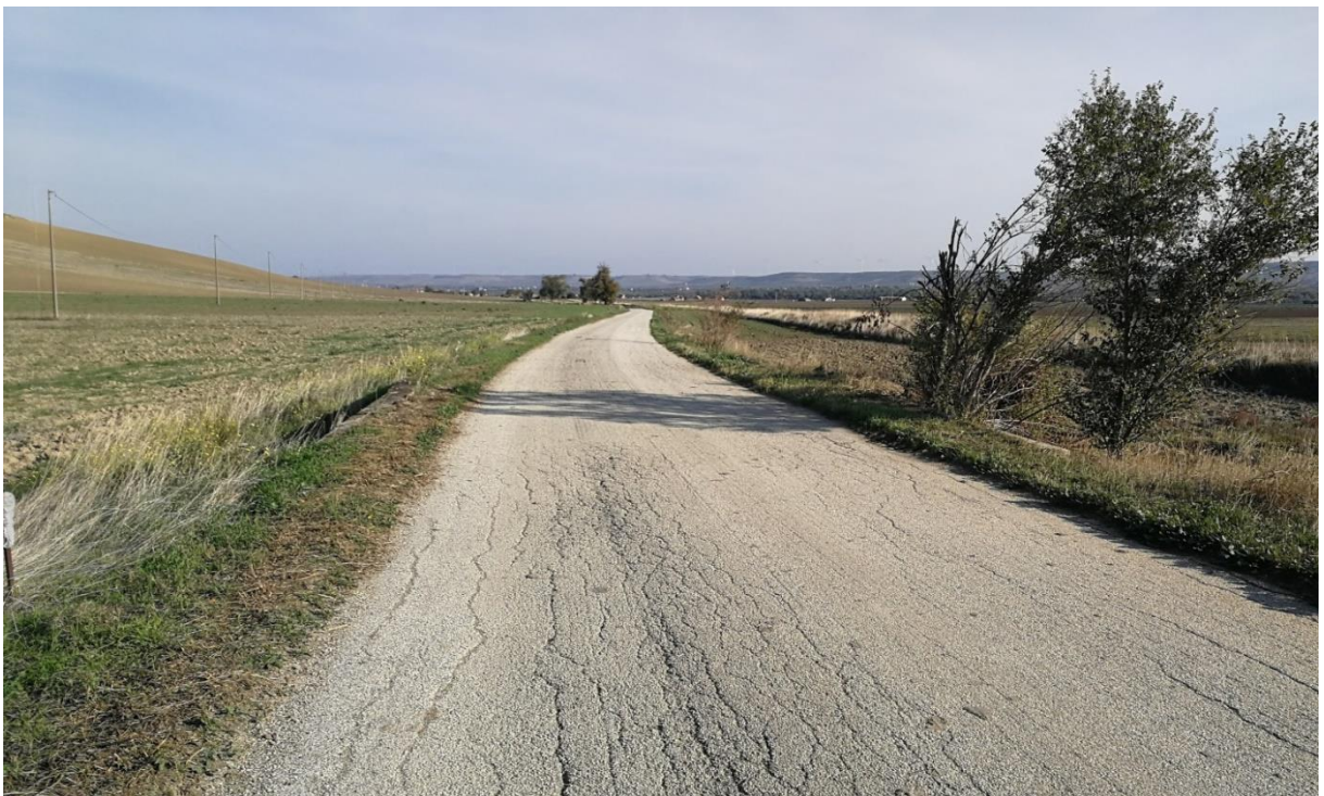
Figura 3-13: S.P. 89 interna all'area protetta (Cavidotto AT)
