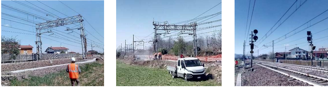
Figura 11: Portali TE e Segnali di protezione della stazione di Torrizza da riposizionare
