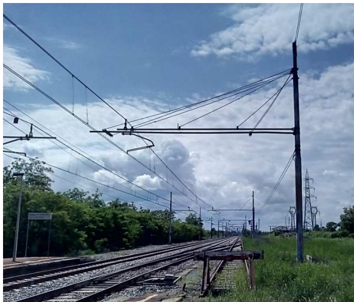
Figura 1: Stazione Torrazza - Binario di precedenza dispari non più elettrificato
