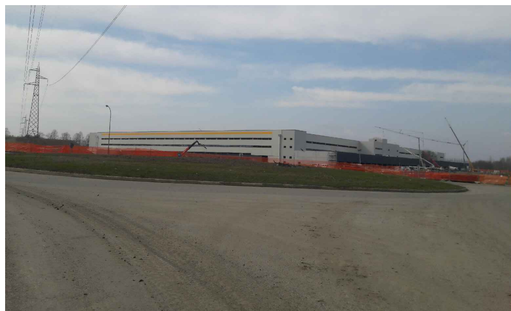
P5 - Vista del polo logistico Amazon durante la fase di costruzione. Il polo è posto a nord del sito di deposito ed è attualmente in esercizio.
