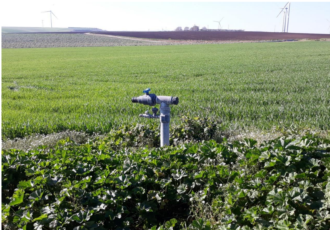
Idranti della rete irrigua aziendale
