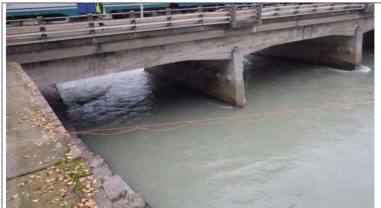
Fig. 9 – Cavo elettrico (giallo) fissato alla fune di sostegno (arancione), con elettrodi a livello dell’acqua, sponda sinistra F. Isarco
