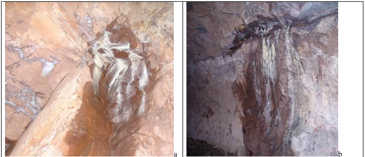
Figura 46. Venute d'acqua rilevate lungo il cunicolo: a) stillicidio alla pk 0+110 circa; b) piccola venuta d'acqua poco oltre la zona centrale caratterizzata dai maggiori rilasci in calotta.
