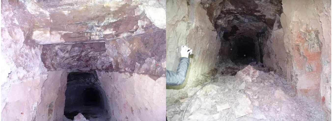
Figura 29. Fenomeni di crollo in volta dovuti alla presenza dei piani suborizzontali oltre la pk 0+240.
