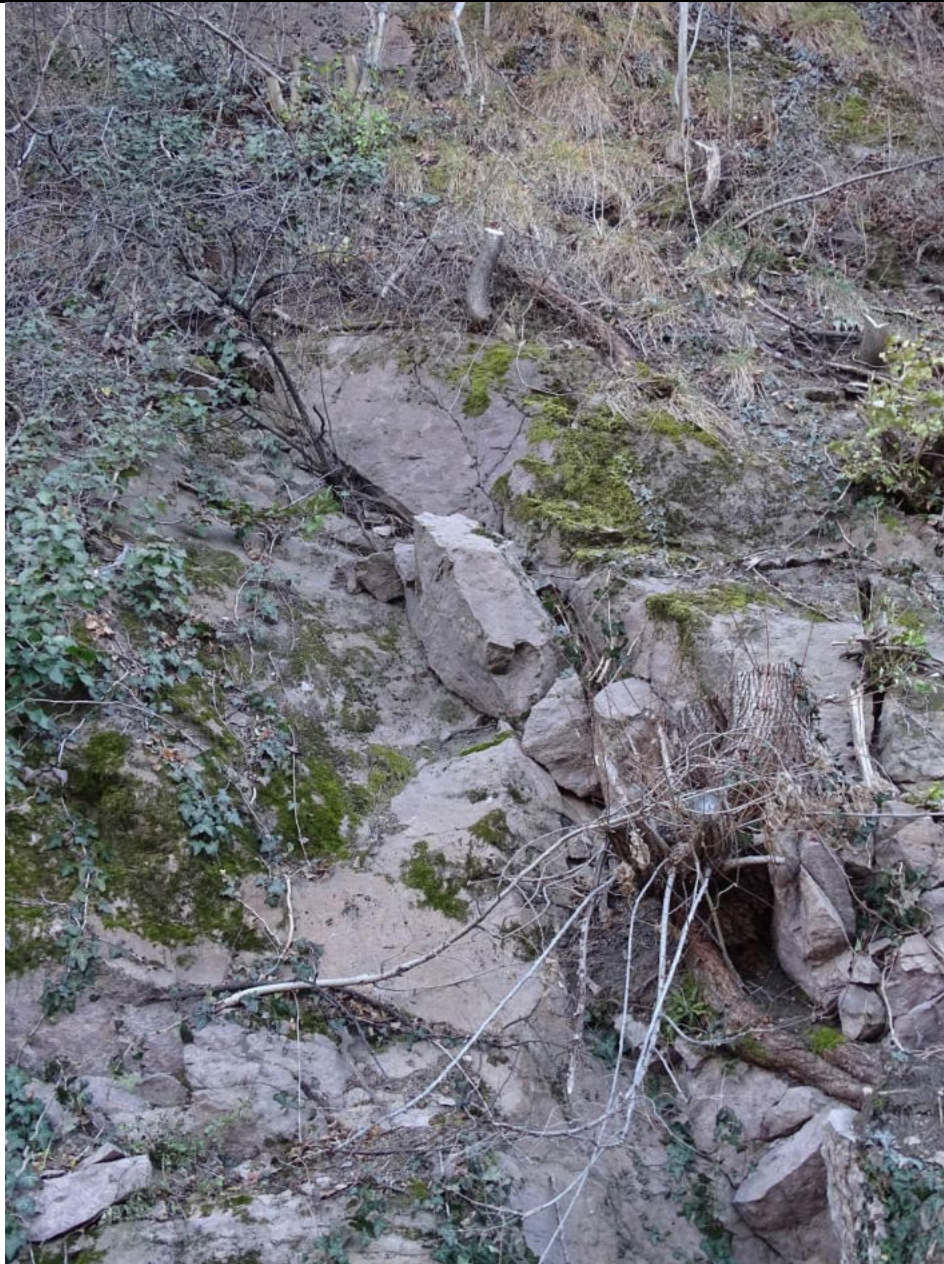
Figura 10. Volumi in stabilità precaria sopra via del Calvario allo stop 1440
