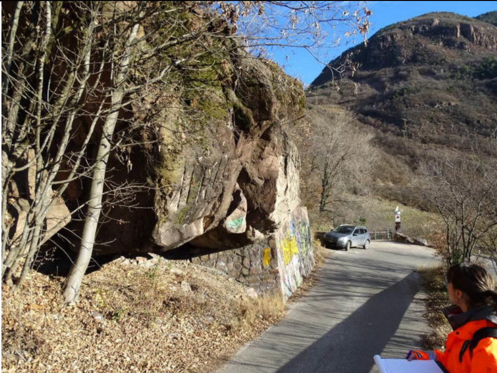
Figura 22. Affioramento di ORA con megablocchi svincolati
