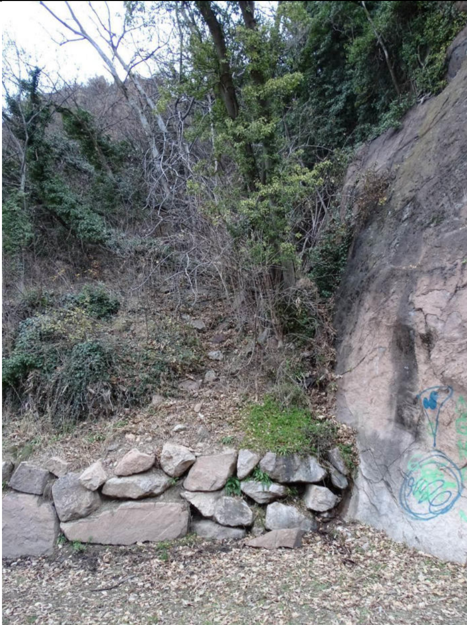
Figura 98. Contatto tra roccia in posto e detrito di versante con modesta venuta d'acqua alla base del muro a secco
