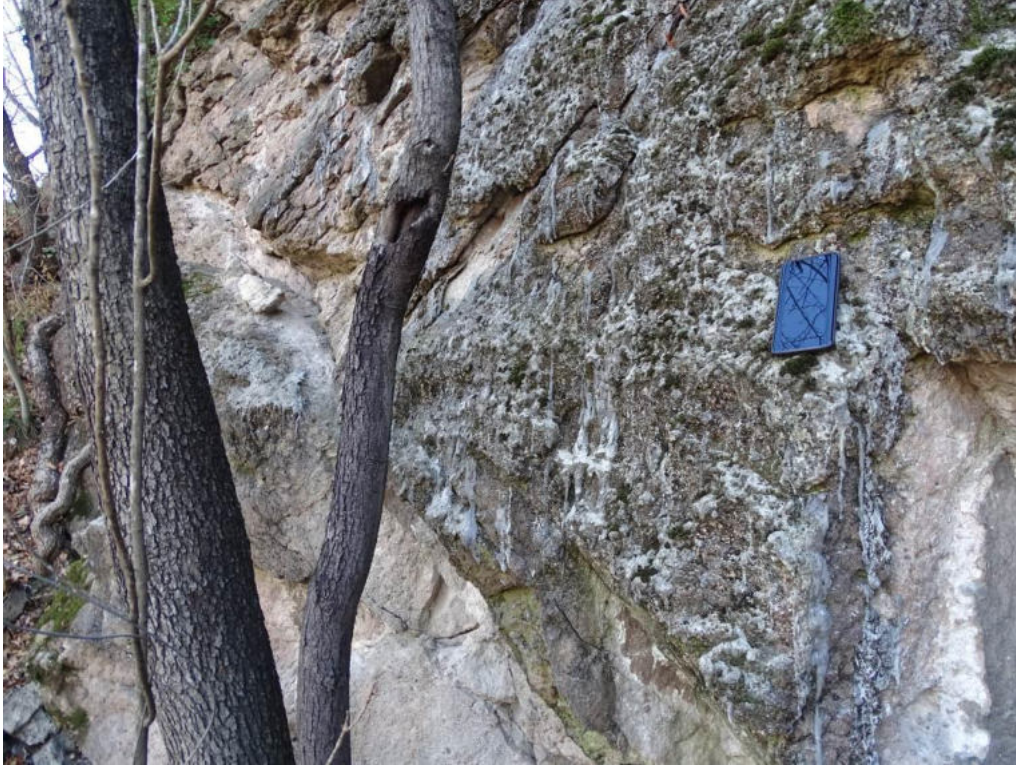
Figura 95. Zona basale della parete principale di ORA alterata e con colature di boiacca dovute ai consolidamenti soprastanti
