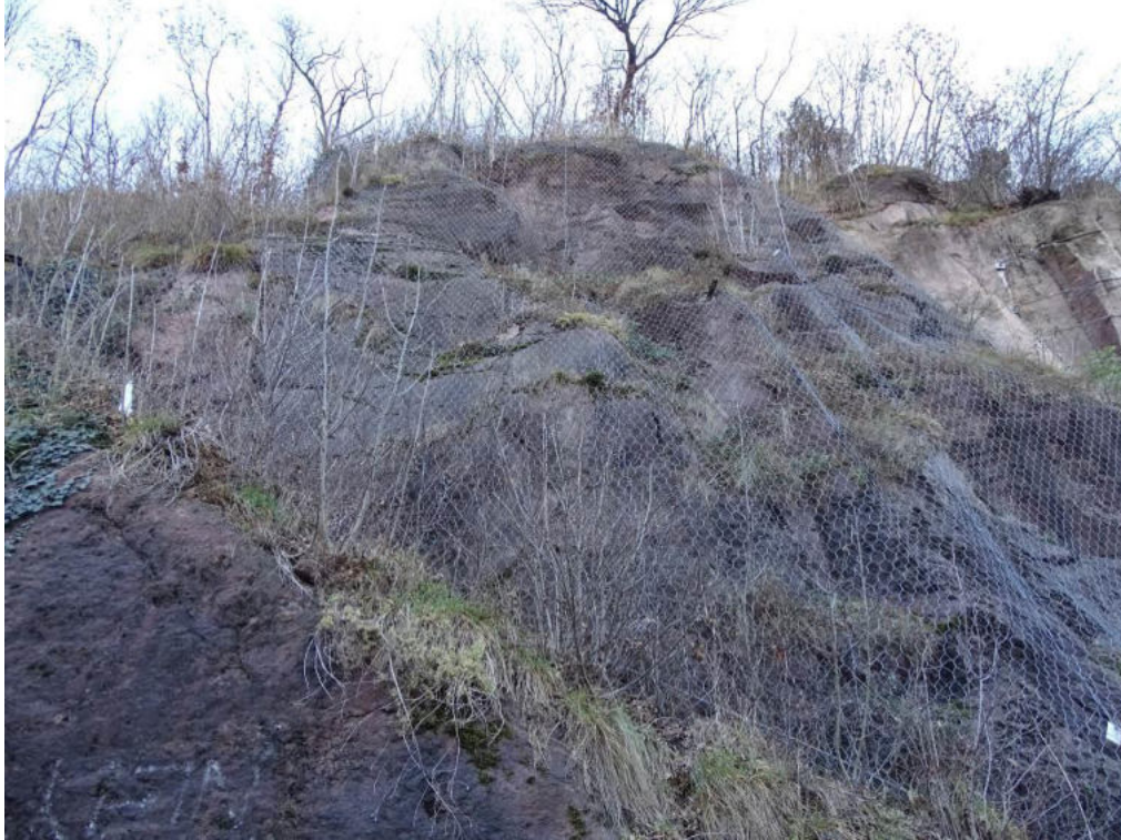
Figura 14. Parete con rete metallica in aderenza all'incrocio tra Via del Calvario e Via Piè di Virgolo
