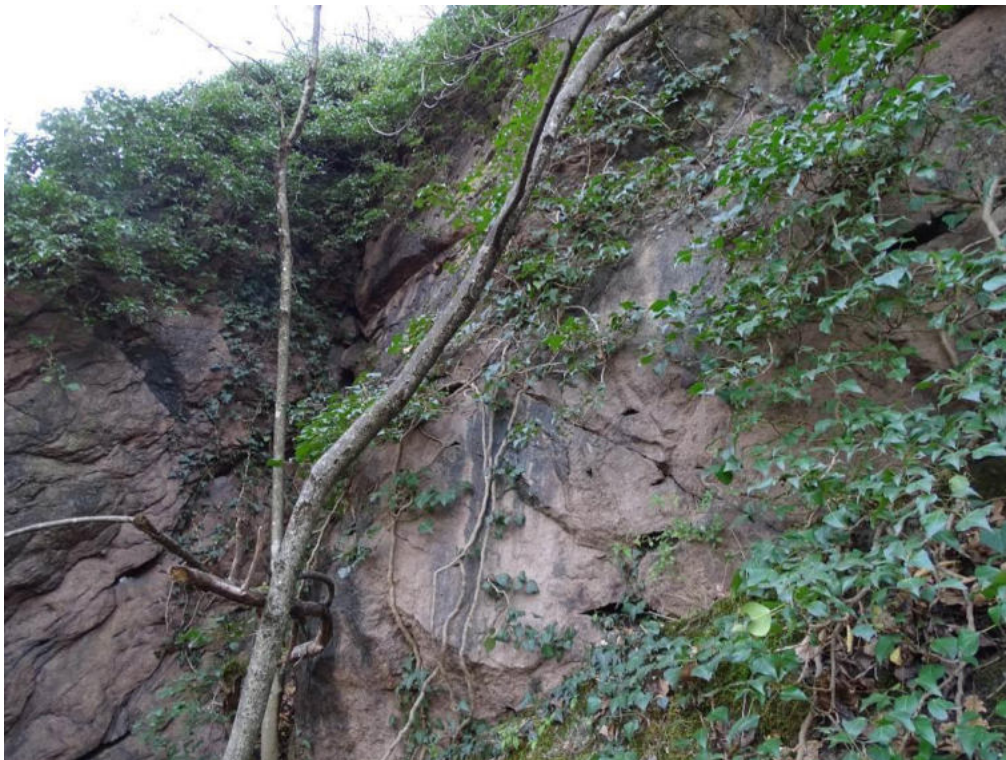
Figura 60. Blocco potenzialmente instabile a tergo del muro
