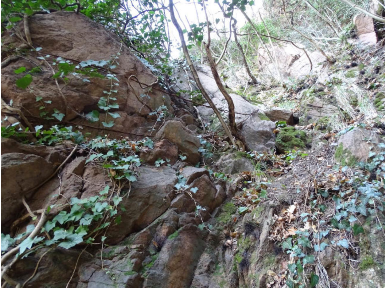
Figura 68. Blocchi plurimetrici svincolati, protetti con vecchie legature. Presenza di zona di faglia.
