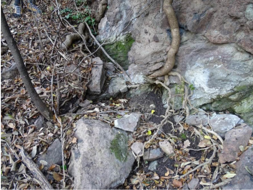
Figura 74. Venuta d'acqua alla base della parete
