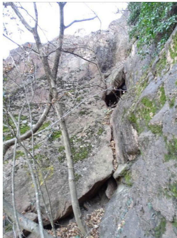
Figura 63. Blocco instabile a tergo del muro
