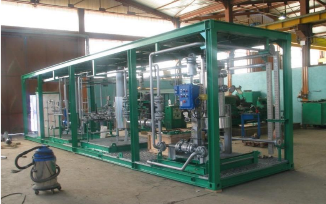
Figura 24: Modulo P.C.M. prefabbricato contenente i Moduli SK2 / SK3 / SK4 / SK5 (allestimento in officina per analoga apparecchiatura/progetto GPI).
