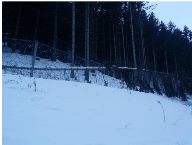
Rete paramassi danneggiata
