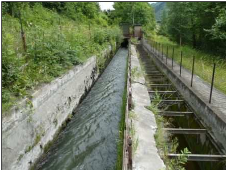
Figura 147 – manufatto sfioratore Pontet - Ingresso in galleria sprovvisto di griglia
