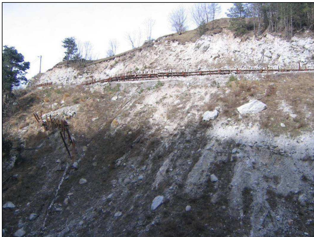
Figura 60 – Versante sinistro a valle dell’opera di presa di Serre La Voute. Deposito di frana
