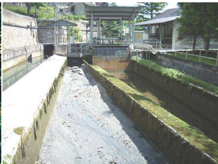
Nodo idraulico a monte delle vasche di carico e delle condotte (sopra)
