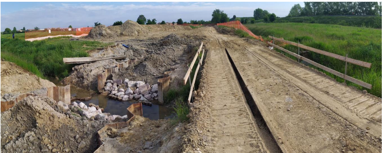
Fig. 3 – Particolare cantieristico dell'attraversamento Scolo Lusore (ASP02BO). Attraversamento mezzi con ponte volante e scavo di posa a larghezza ristretta
