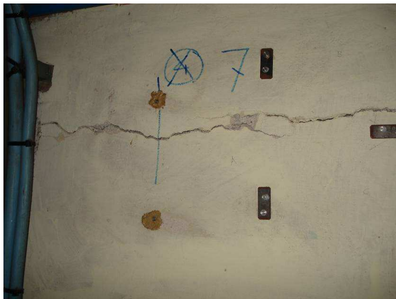
Figura 22 – stato fessurativo interno centrale di Chiomonte (Dicembre 2008)
