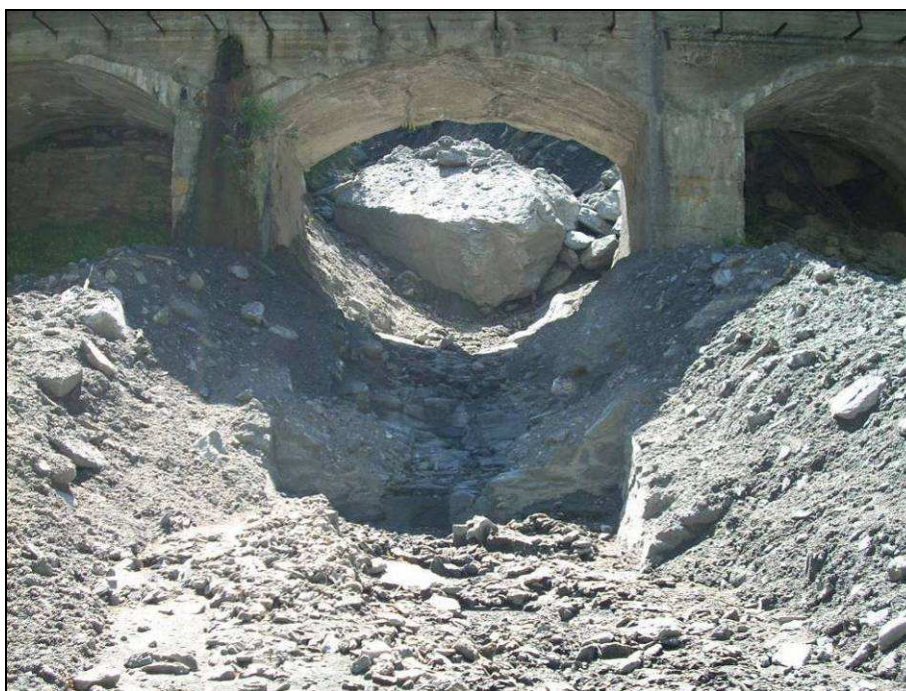
Figura 5 – tratto di canale di derivazione in corrispondenza dell'impluvio naturale interessato da notevole trasporto di materiale solido
