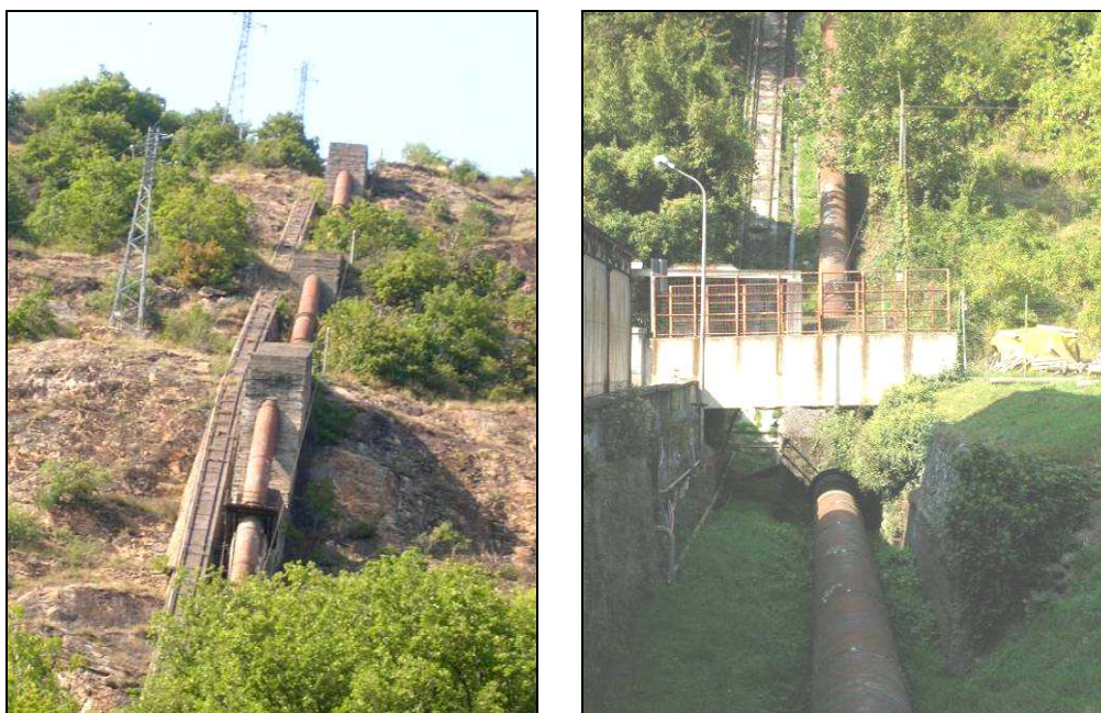
Figura 17 – condotta forzata n°3 in versante (a sinistra) e al piede in ingresso alla centrale (a destra)
