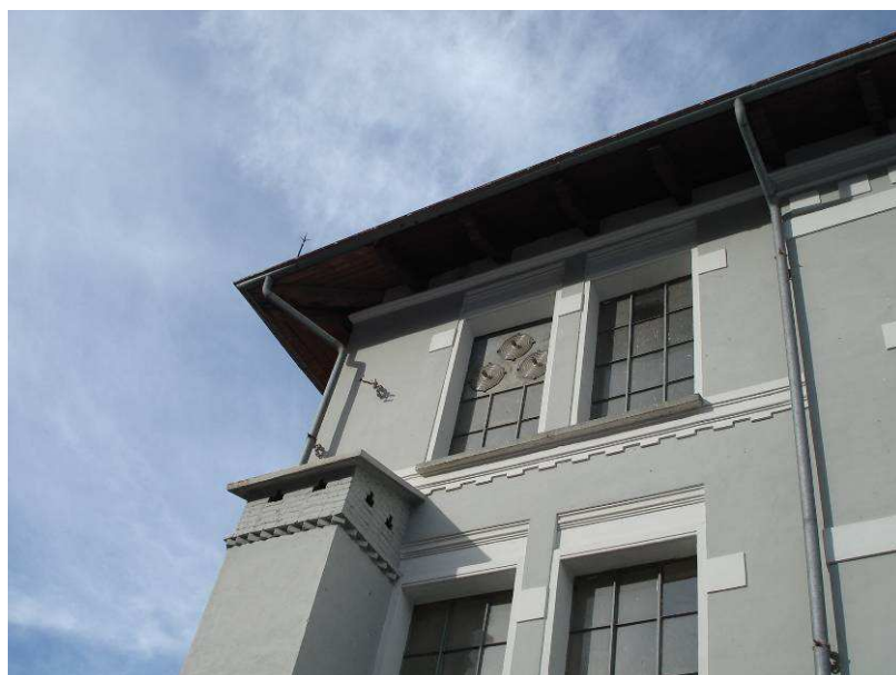
Figura 25 – dettagli dei pluviali in rame della centrale di Chiomonte riproposti nel nuovo fabbricato centrale
