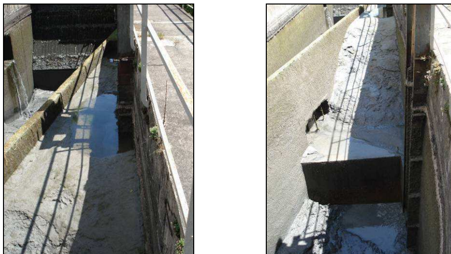
Figura 10 – stato di consistenza setto centrale manufatto dissabbiatore a monte della camera di carico n° 3
