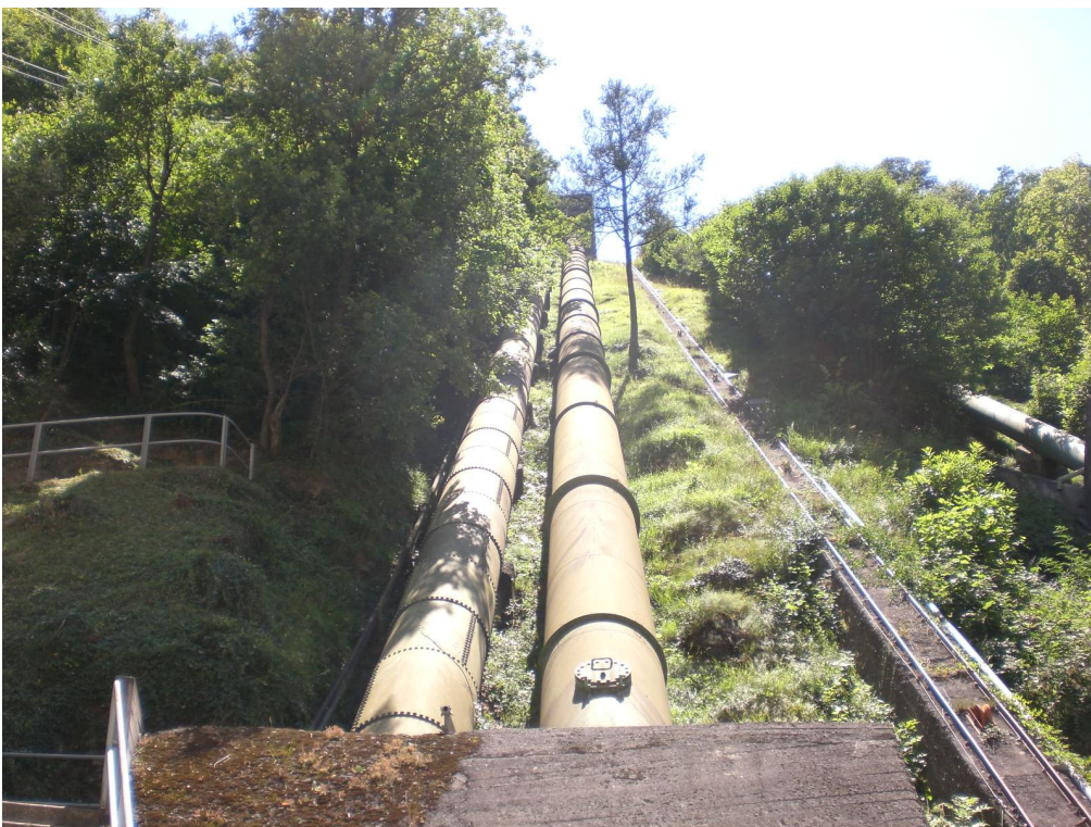
SITO N.01 – CENTRALE DI SUSA – CONDOTTE FORZATE
