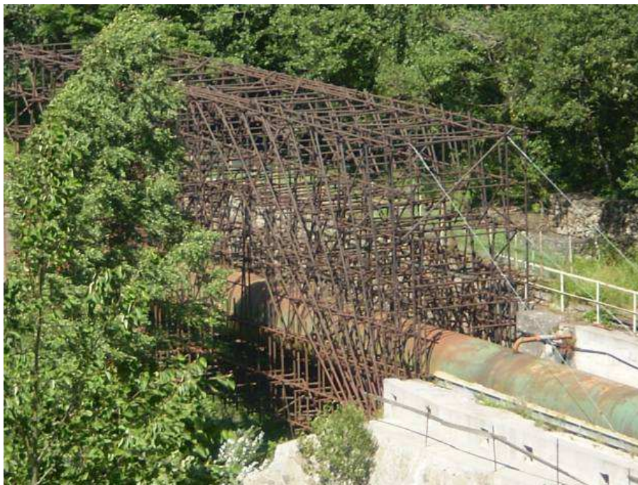
Figura 22 - Struttura di sostegno in tubolari di tipo “Innocenti” in corrispondenza dell'esistente ponte-tubo oggetto di intervento
