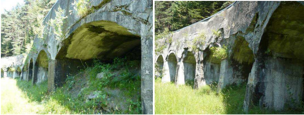
Figura 24 - Tratti ammalorati del canale derivatore fino al sifone sulla Dora Riparia.
