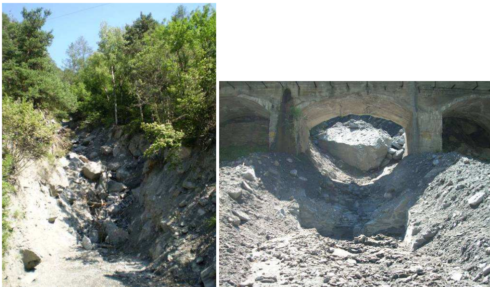
Figura 23 - dissesto idrogeologico in destra idraulica lungo l'inciso del Rio Sapè. Sono previsti interventi di consolidamento mediante formazione di scogliera in massi ciclopici
