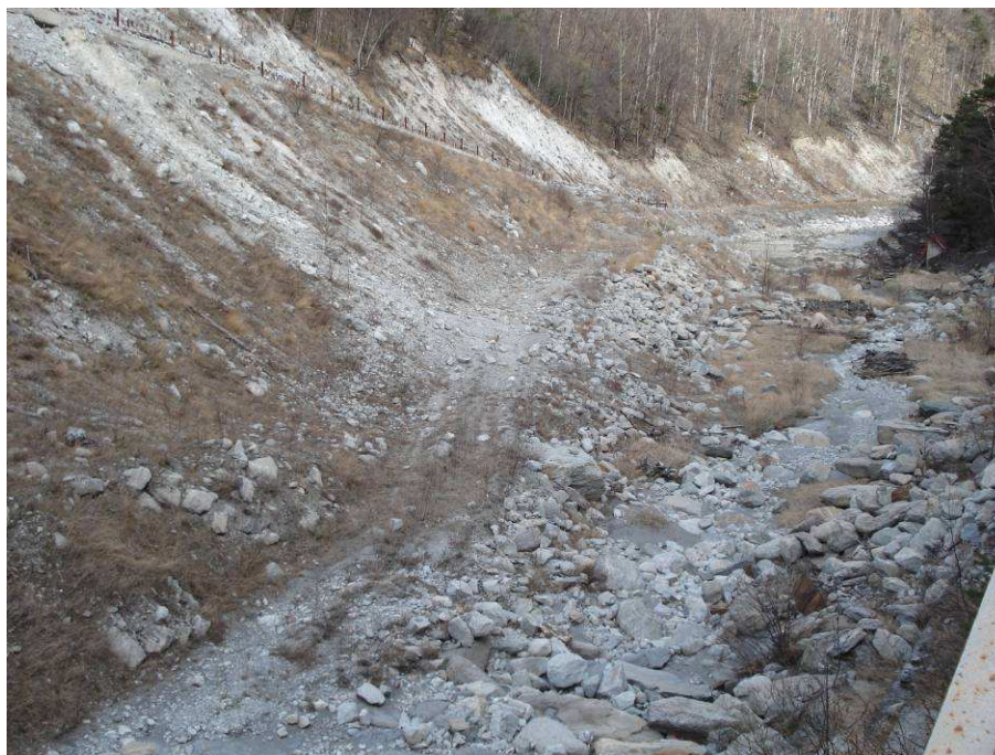
Figura 25 – tratto di viabilità di cantiere per accedere al canale di derivazione per l'esecuzione dei lavori
