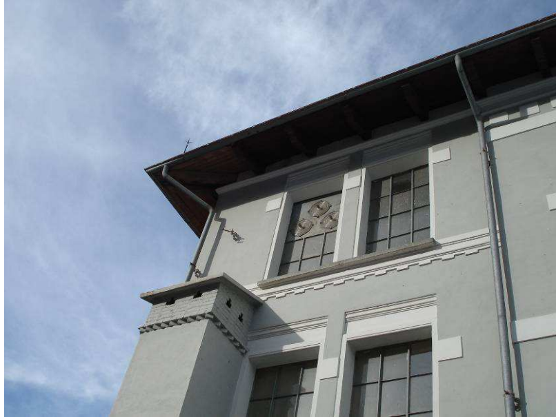
Figura 35 – dettagli dei pluviali in rame della centrale di Chiomonte riproposti nel nuovo fabbricato centrale
