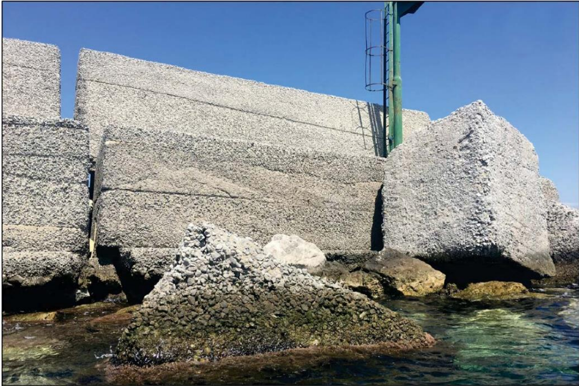
Figura 10.3 - Report fotografico ammaloramento diga di sopraflutto
