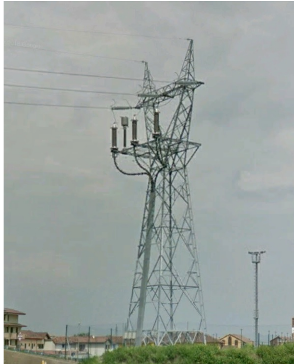
Palo predisposto con la piattaforma per la transizione aereo-cavo per una linea 220 kV
