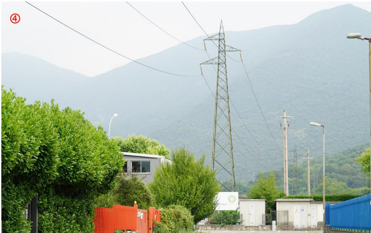
Fig. 6. Elettrodotto 123 su area industriale
