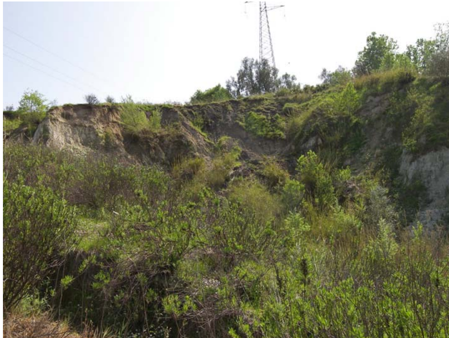
Smottamenti che interessano la coltre di alterazione scarpata di scavo.
