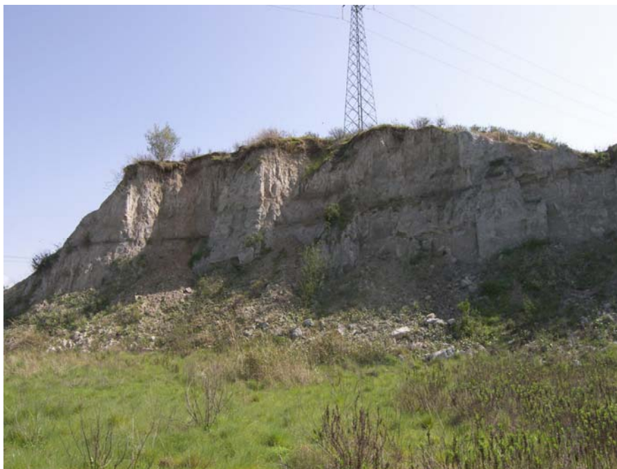
Fenomeno del distacco di blocchi argillosi dalla scarpata di scavo.
