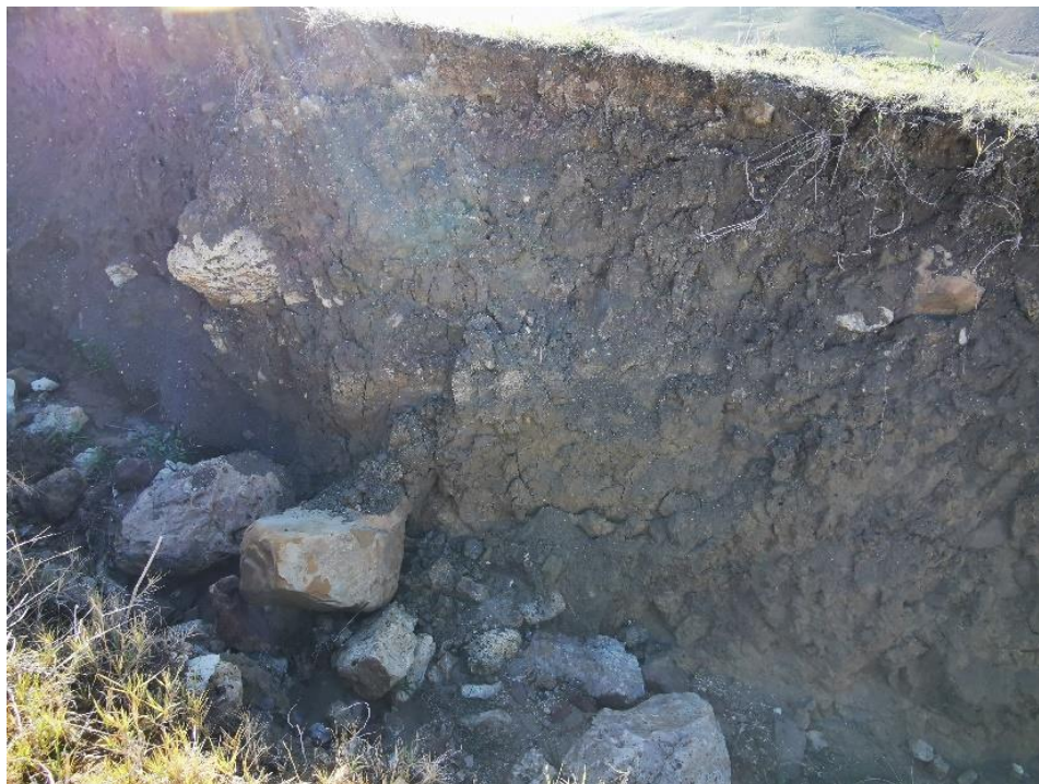
Foto 14: Solco di erosione su versante a franosità diffusa
