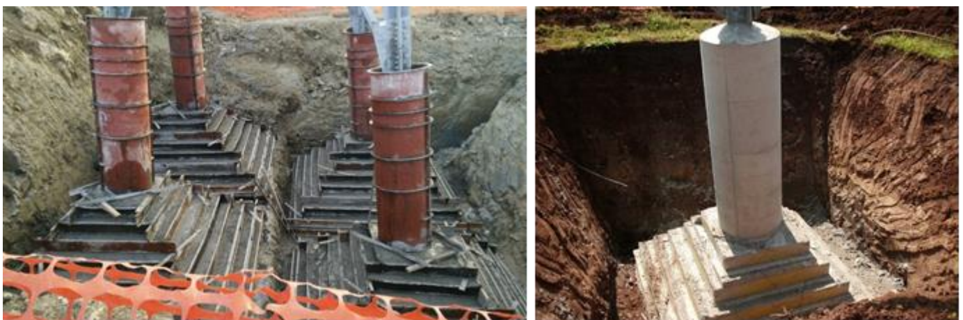
Figura 6: Realizzazione di fondazioni superficiali tipo CR per un sostegno a traliccio. Particolare di una fondazione durante la fase di casseratura (a sinistra) e al termine della stessa (a destra), dove si possono distinguere facilmente la parte inferiore a parallelepipedi tronco piramidali ed il colonnino di raccordo con la "base" del sostegno.
