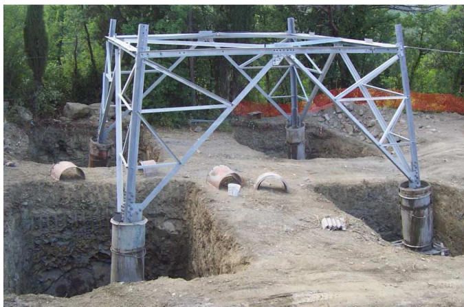
Figura 7: Realizzazione di fondazioni superficiali tipo CR per sostegno a traliccio. Nell'immagine si osservano le quattro buche, la base del sostegno collegata alla fondazione tramite i "monconi" e i casseri utilizzati per i quattro "colonnini".
