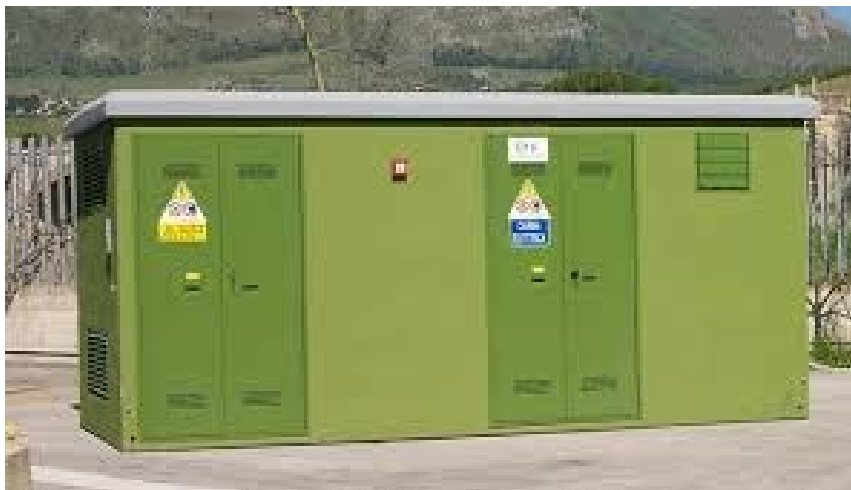
Figura 33: Mitigazione cabine di campo
