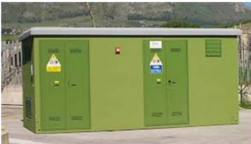
Figura 10: Cabina prefabbricata tipica utilizzata in progetto
