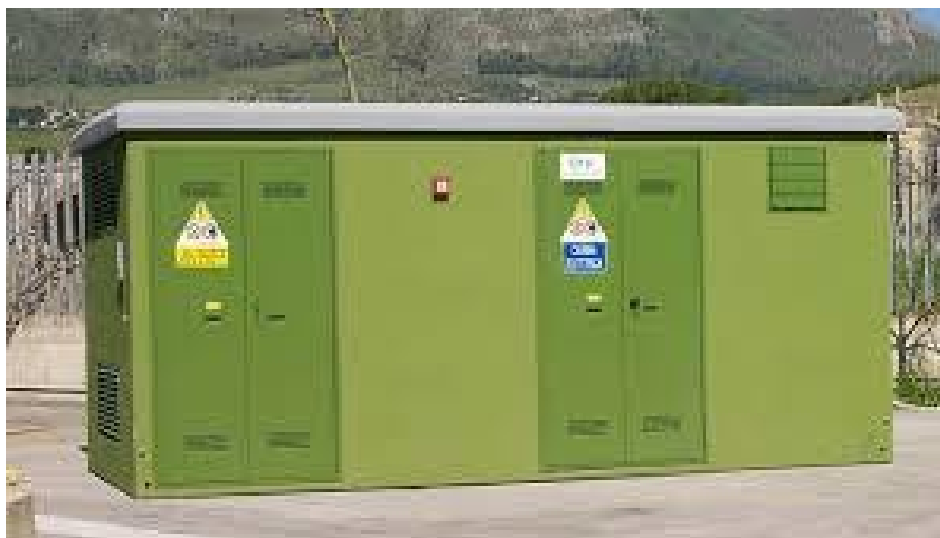
Figura 10: Cabina prefabbricata tipica utilizzata in progetto
