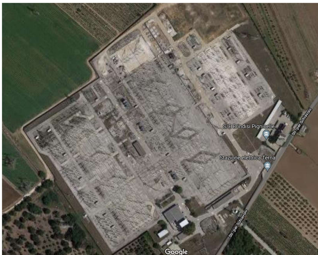
Stazione di Trasformazione 380/150 kV TERNA SpA "Brindisi Pignicelle"
