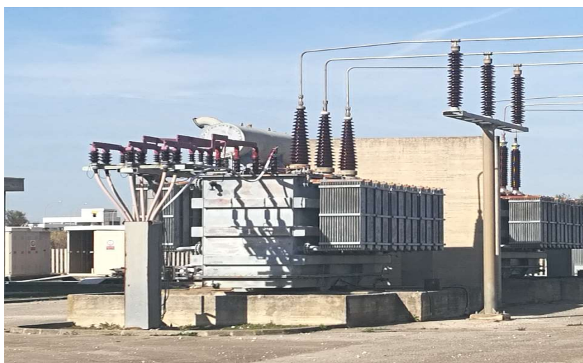
Tipico trasformatore di potenza AT/MT ONAN
