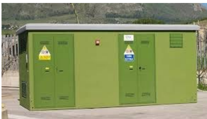
Fig. 11 – Cabina elettrica monolitica in Ral 6002
