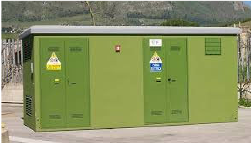
Figura 25: Mitigazione cabine di campo
