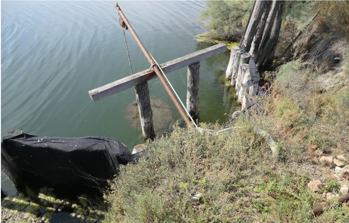
Figura 3.7 – Palassa Baiona, Chiaro del Paradiso: tubo di collegamento con il canale Baccarini. Foto in data 14/09/2021.
