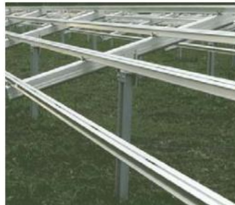
Struttura di sostegno delle stringhe di moduli.
