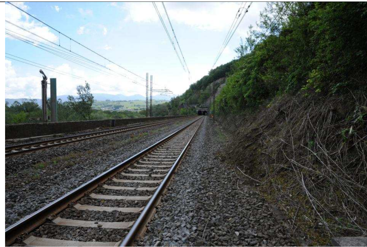
Foto n° 25 – Vista verso est dal tracciato ferroviario. Sullo sfondo la galleria del nodo 2
