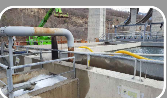
Impianto trattamento acque
