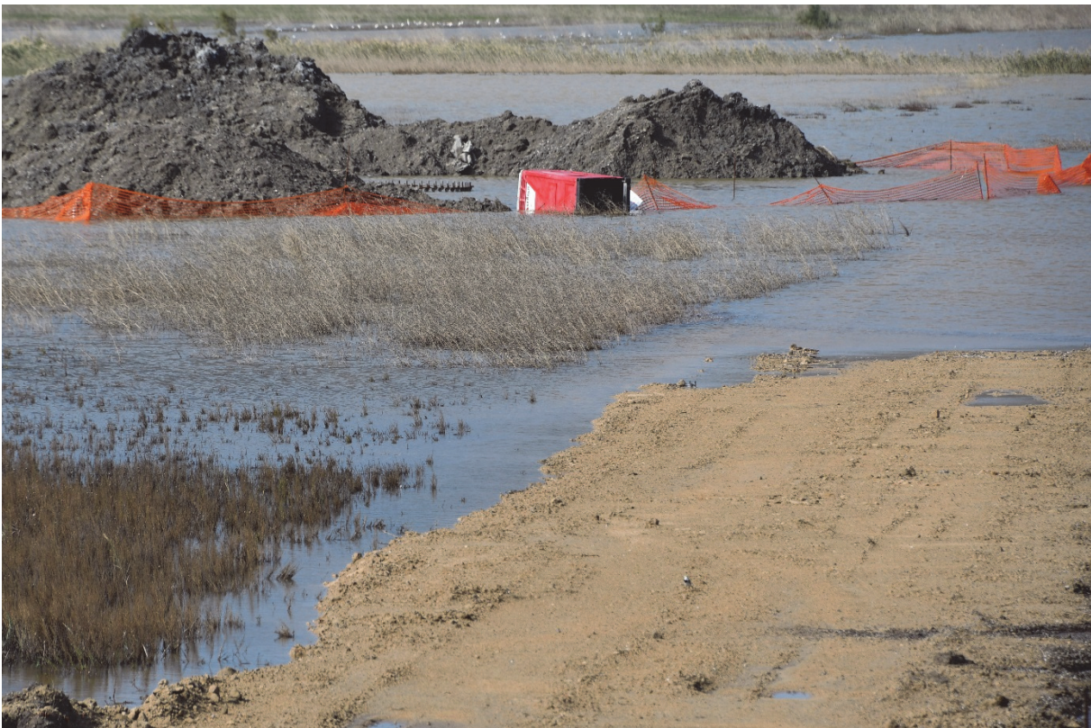
Foto 11 - Tratto di pista, in parte sommerso dalle acque, realizzato con materiale di riporto (cantiere del sostegno 35) – Foto scattata al pantano Lentini il 30 ottobre 2021.
